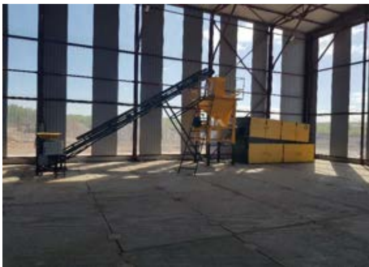
Рисунок 17 – Линия технологическая механической переработки битумосодержащих материалов (Кровельных отходов) ПБМ
